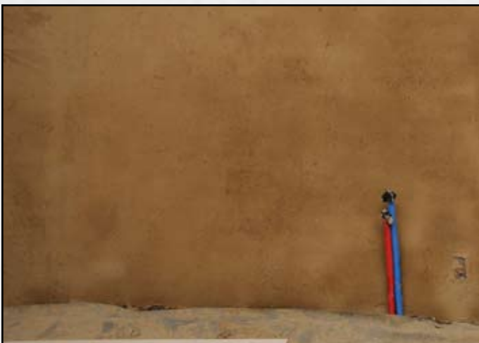
Vochtplekken in een leemwand
